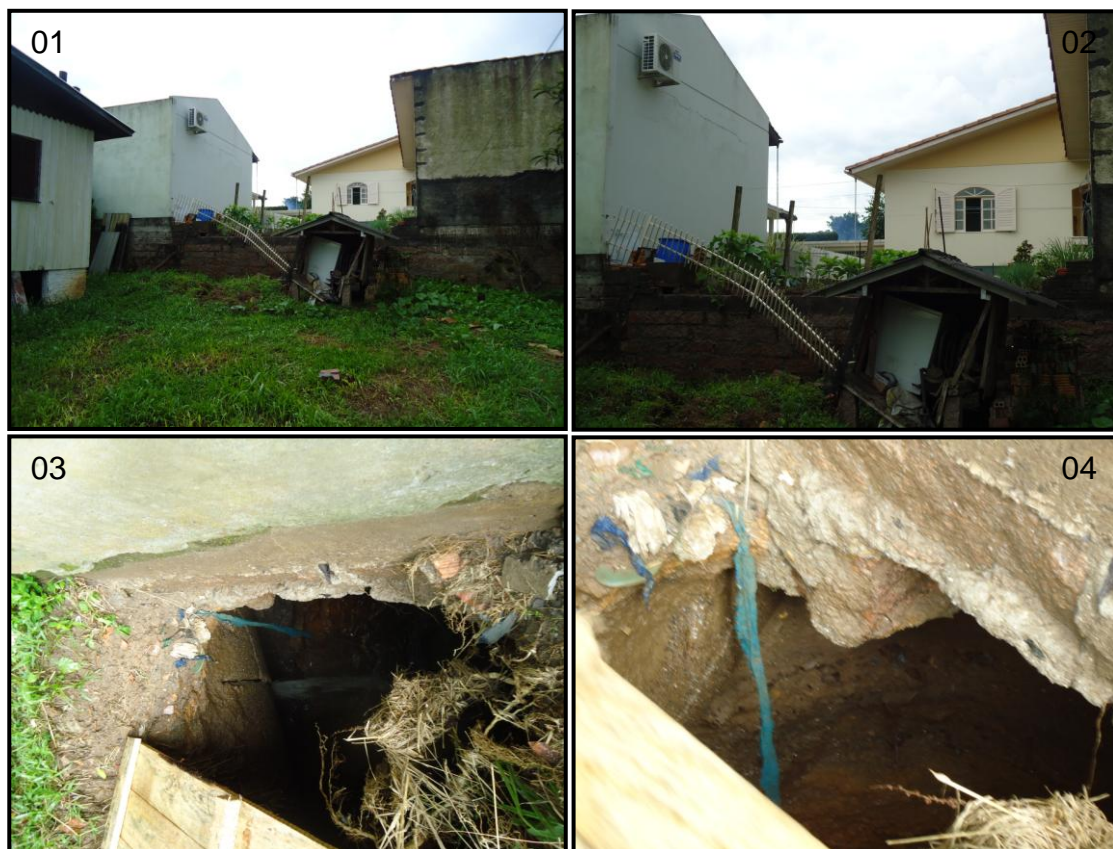
Fotografia 01 a 04: Aspectos dos danos em obras civis advindos de subsidência de antiga mina de carvão na localidade do bairro Rio Maina, Criciúma/SC. Fonte: Garcia, et. al. SIESESC (2010).
