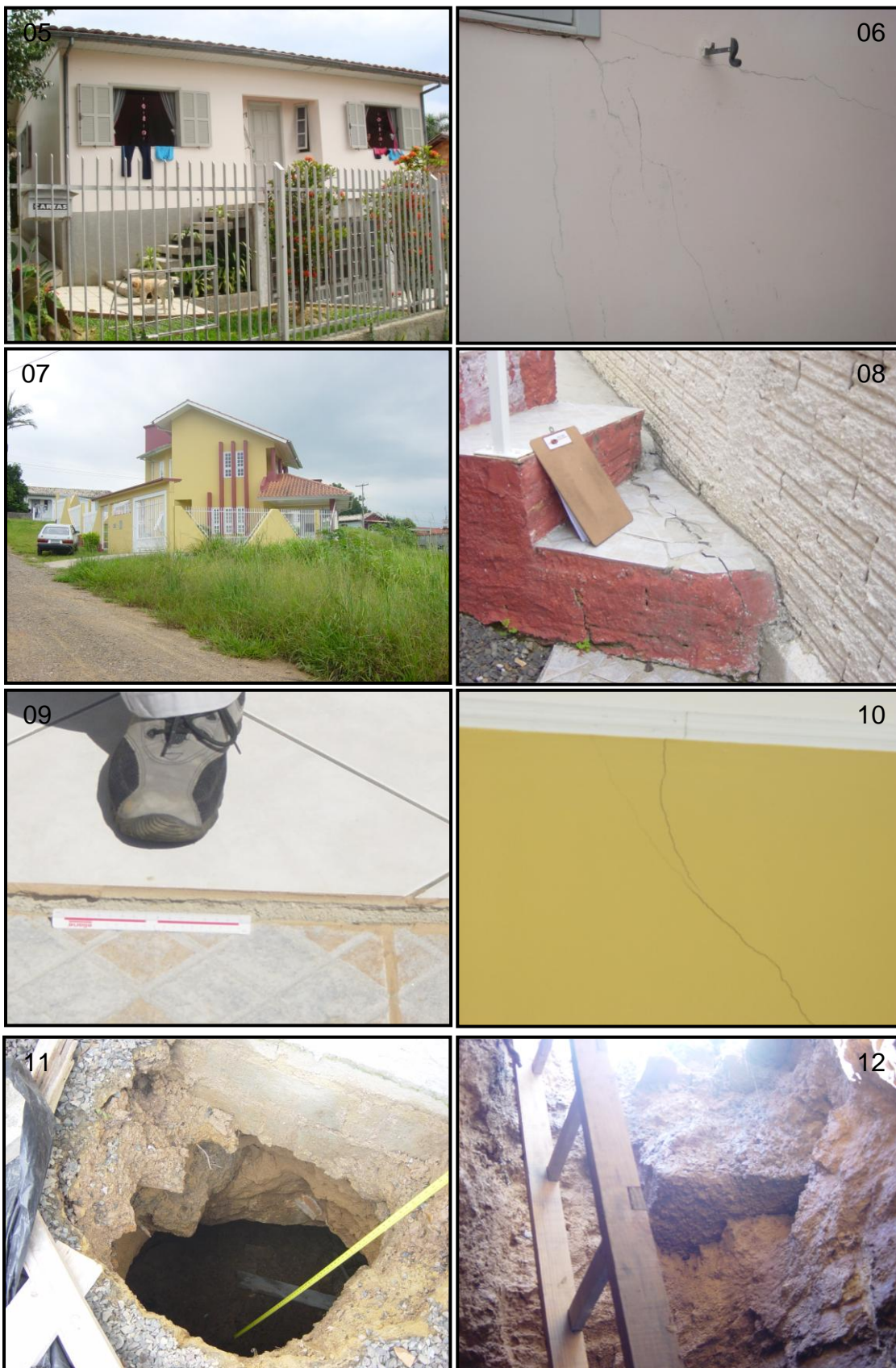
Fotografia 05 a 12: Vista parcial de casa apresentando rachaduras pelo processo de subsidência nas localidades dos bairros Mina do Toco e Maria Céu, Criciúma/SC. Fonte: KREBS, Antônio et. al. SATC e SIECESC (2010).
