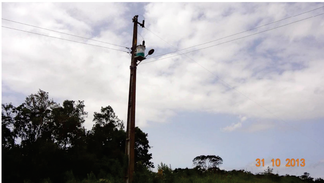
Figura 15 - Transformador com óleo vegetal na rede de distribuição.
