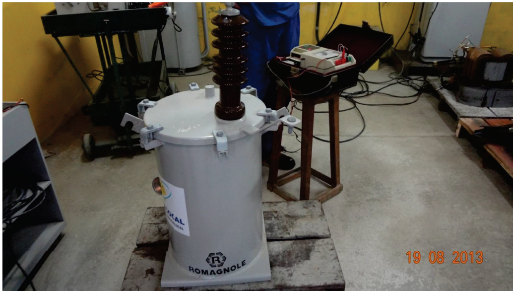
Figura 13 - Ensaio de resistência de isolamento.
