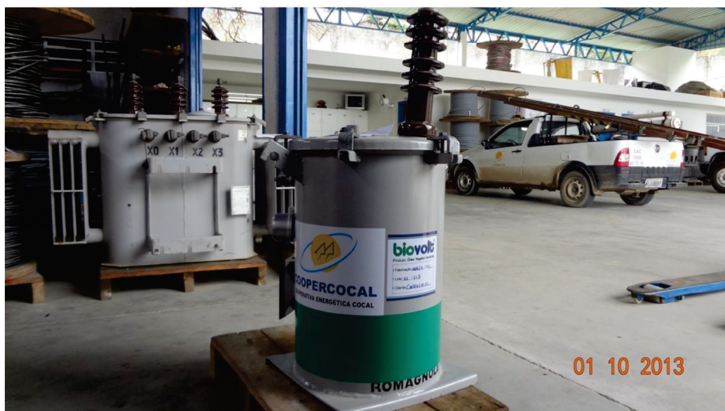
Figura 11 - Transformador lacrado com a logomarca da Biovolt.
