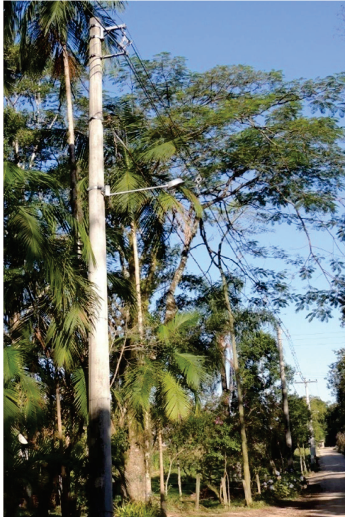
Figura 8 - Distribuição de energia elétrica com utilização de redes compactas.
