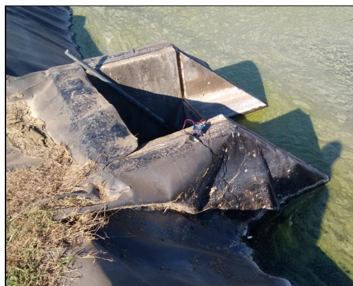
Figura 7. Nó sensor posicionado no tanque de saída da estação
