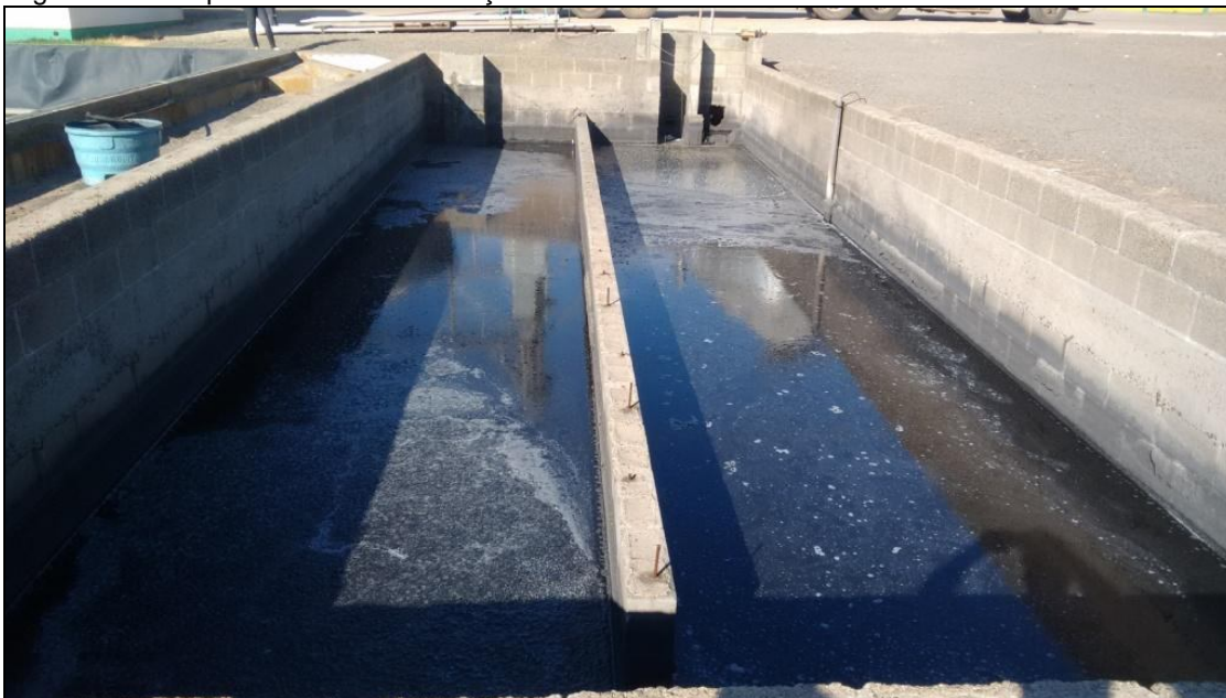
Figura 20 - Tanque de entrada da estação
