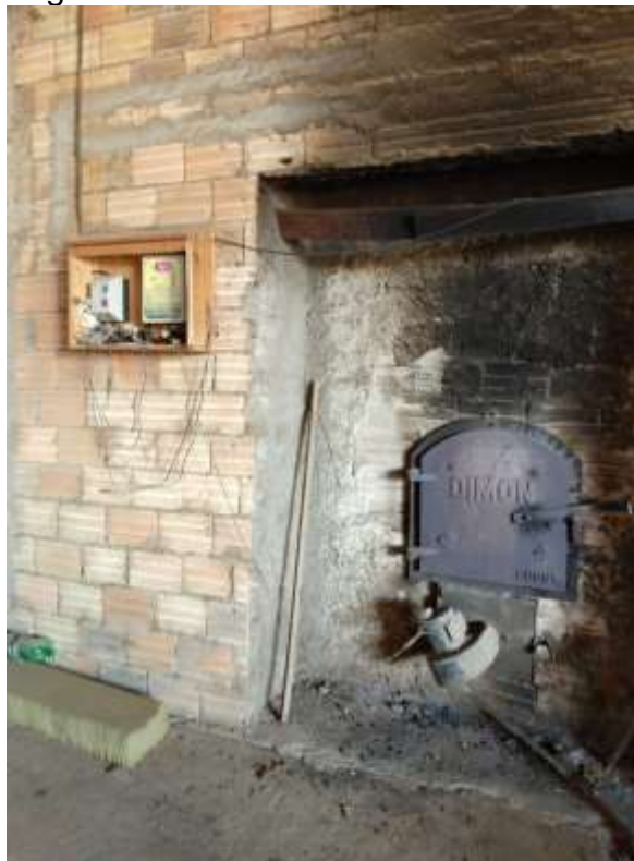
Figura 9 - Fornalha da estufa elétrica
