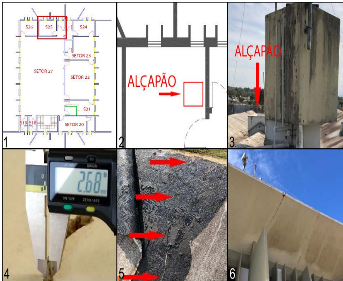
Figura 9. Acesso a cobertura e verificação da espessura e tipo de trinca
