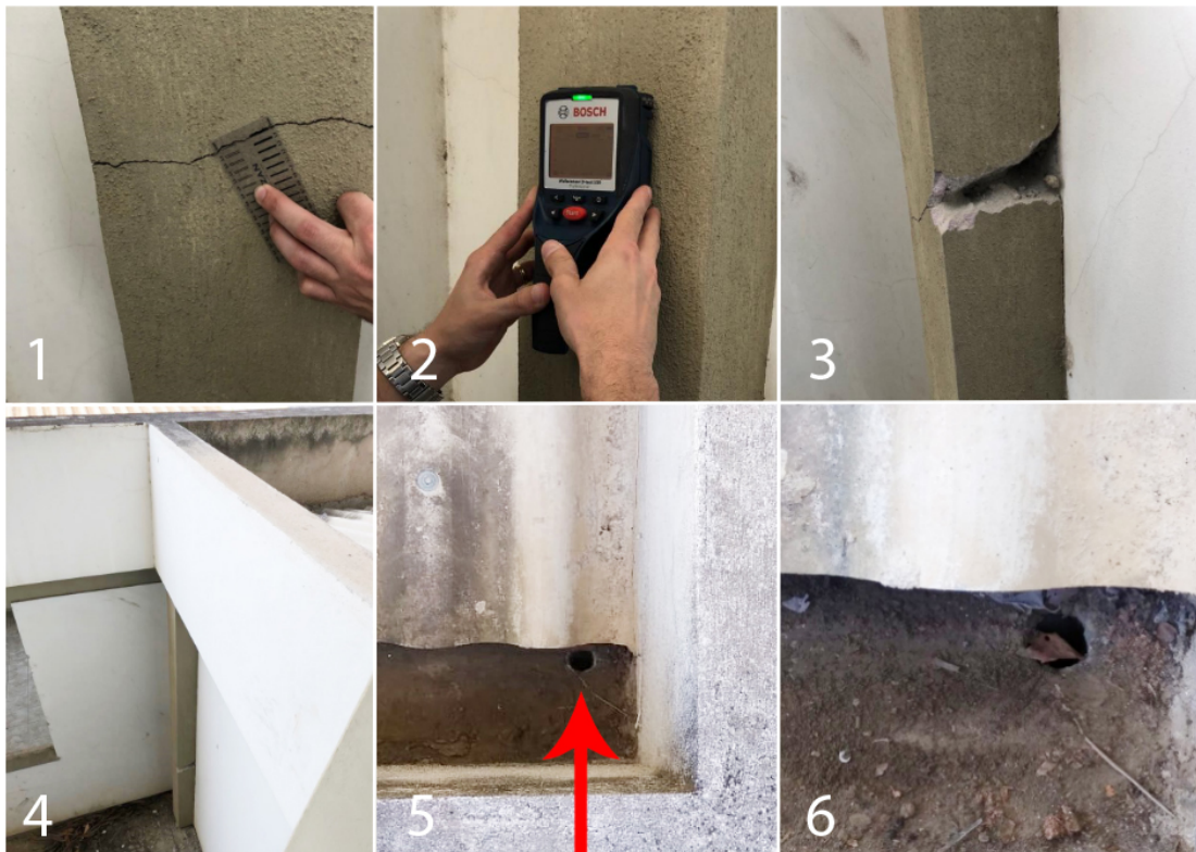
Figura 5: Análise da trinca.
