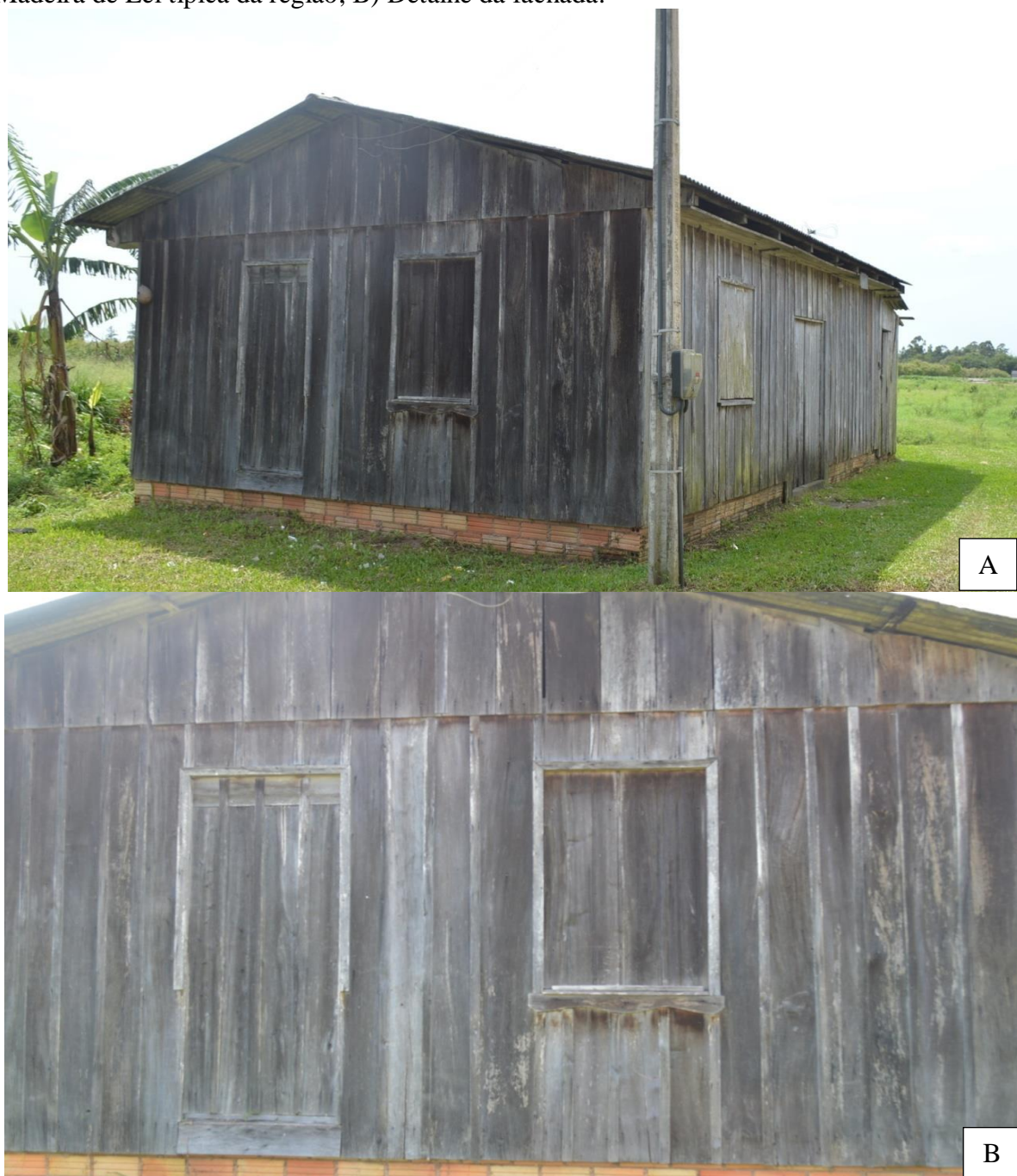
Figura 10: Imagens do sítio 07– Casa em madeira de Lei (Peroba). Onde: A) Casa em Madeira de Lei típica da região; B) Detalhe da fachada.
