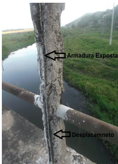
Figura 11: Patologias guarda corpo
