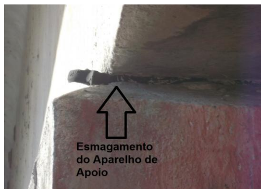
Figura 14: Esmagamento parcial do aparelho de apoio
