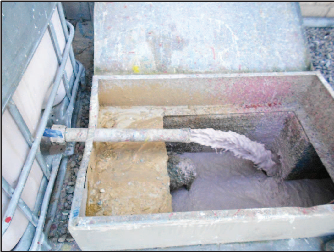
Figura 5 – Calha de recepção de efluentes provenientes da limpeza de equipamentos.
