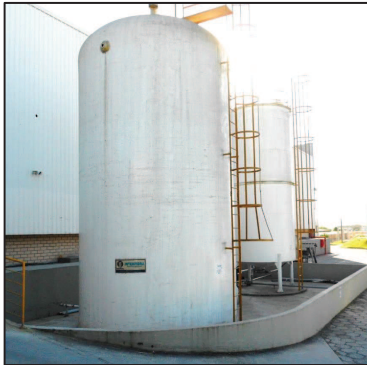
Figura 2 – Tanques de armazenamento de resina.
