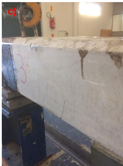
Figura 09(c) – V3 colapsada após reforço.
