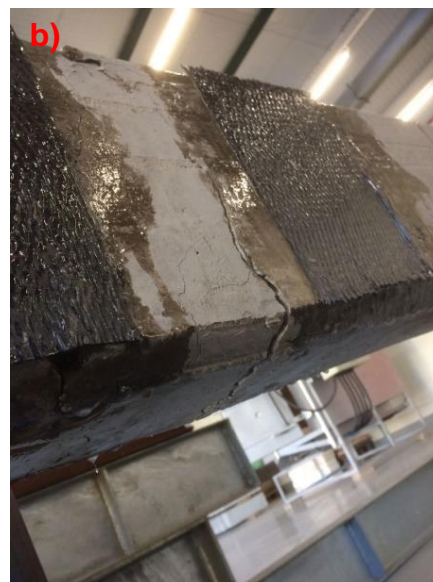
Figura 09(b) – V2 colapsada após reforço.
