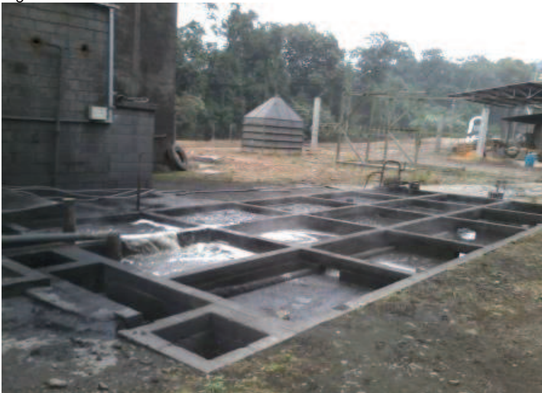
Figura 39 – Decantador da caixa de cinzas
