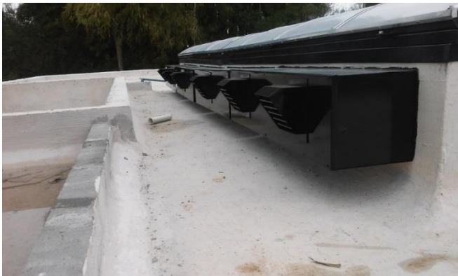
Figura 20 – Sistema de Exaustão presente na garagem
