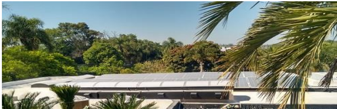
Figura 17 – Placas fotovoltaicas instaladas na cobertura da residência
