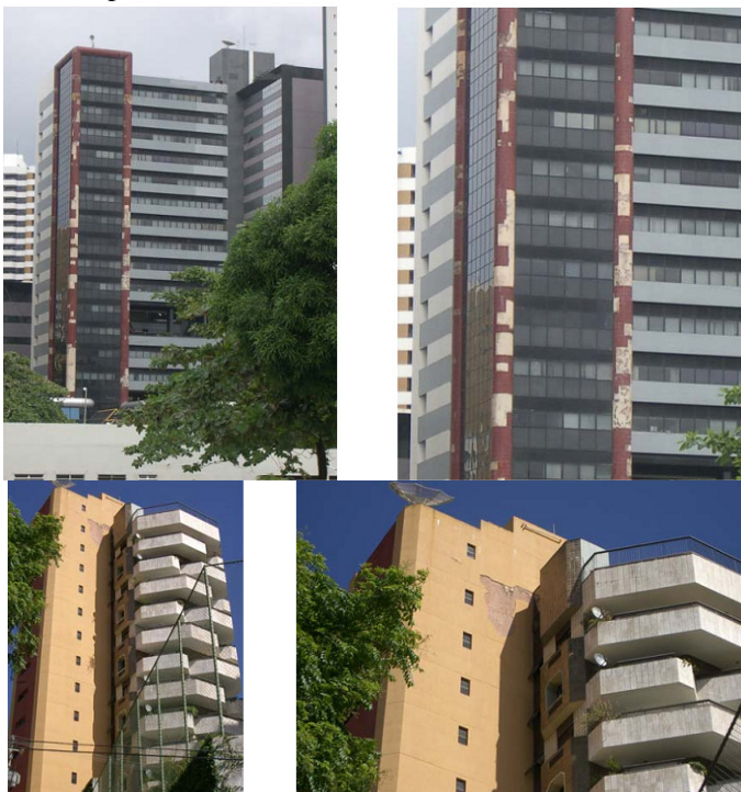
Figura 7 - Exemplos de descolamento.
