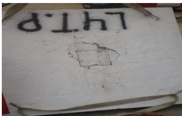
Figura 10- ruptura das lajes.
