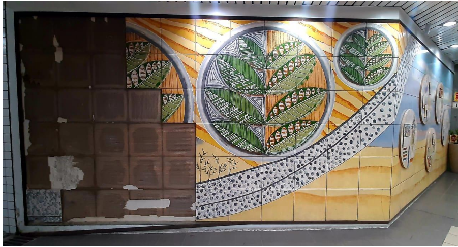
Figura 02 – Estado atual do Painel cerâmico de Jussara Guimarães em agosto de 2024.
