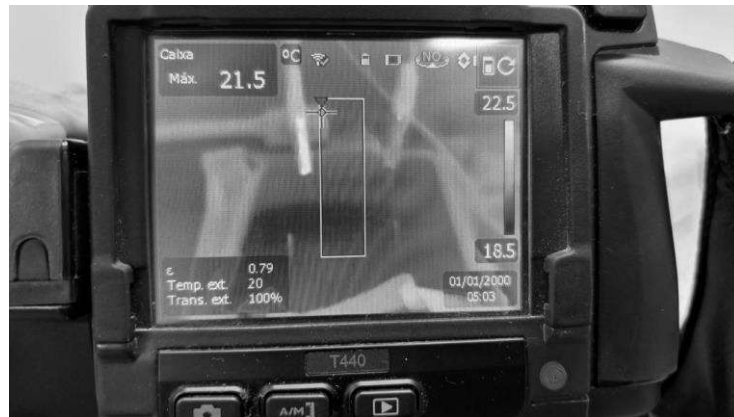
Figura 9: Placa de concreto sob termografia infravermelha. Fonte: Do autor (2024).
