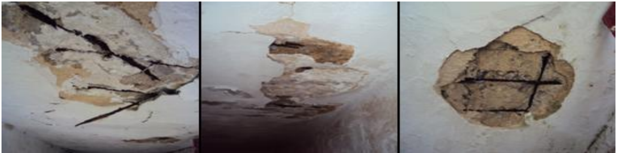
Figura 3: Anomalia de armaduras expostas encontradas.
