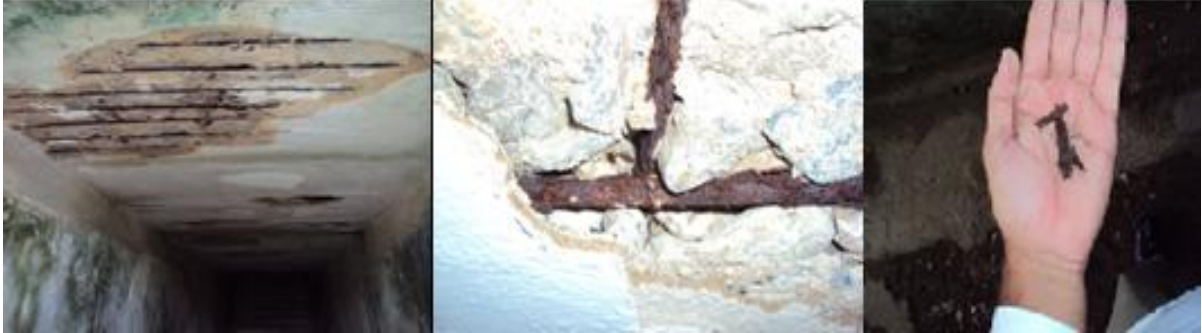
Figura 7: Armaduras expostas oxidadas.
