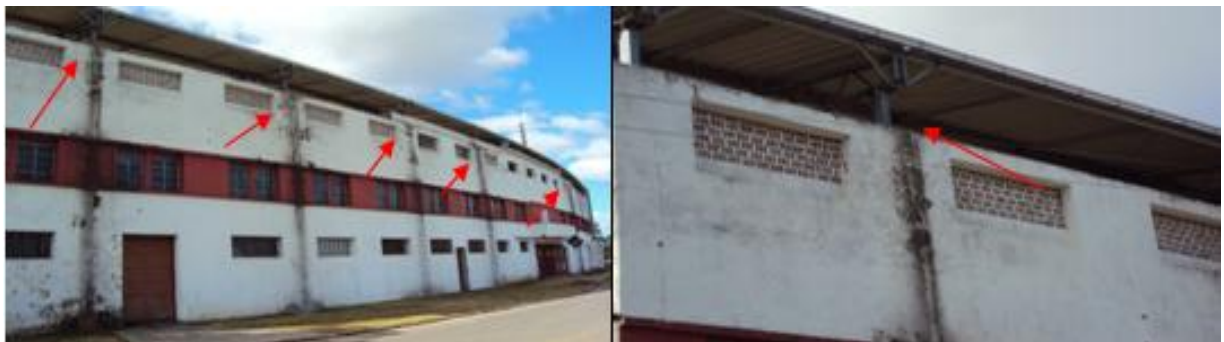
Figura 8: Falta de tubo vertical.
