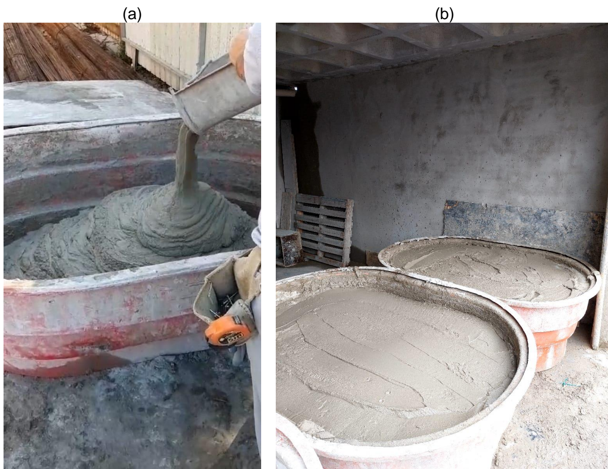
Figura 6: Imagem representativa do momento da entrega (a), e do armazenamento (b) da argamassa estabilizada na obra.
