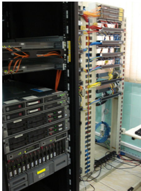
Figura 13. Equipamentos CPD onde se encontram os Servidores de Firewall/Proxy .
